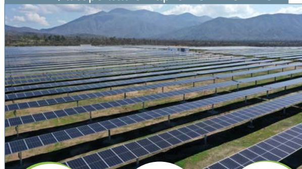
ΧΙΛΗ - Φωτοβολταϊκό Πάρκο ΛΟΣ ΜΟΛΙΝΟΣ
