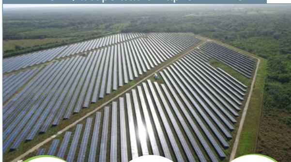
ΜΕΞΙΚΟ - Φωτοβολταϊκό Πάρκο ΚΑΜΠΟΥΛ
