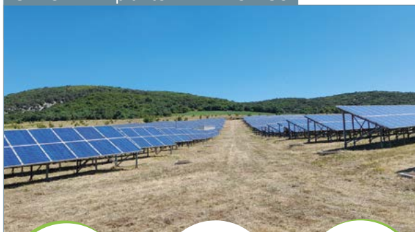
GRECIA - Impianto ILEKTRISMOS
